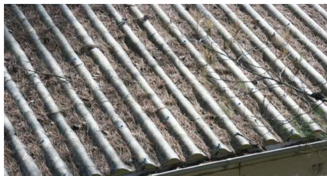
Aiguille de pin : toit encombré, maison en danger
