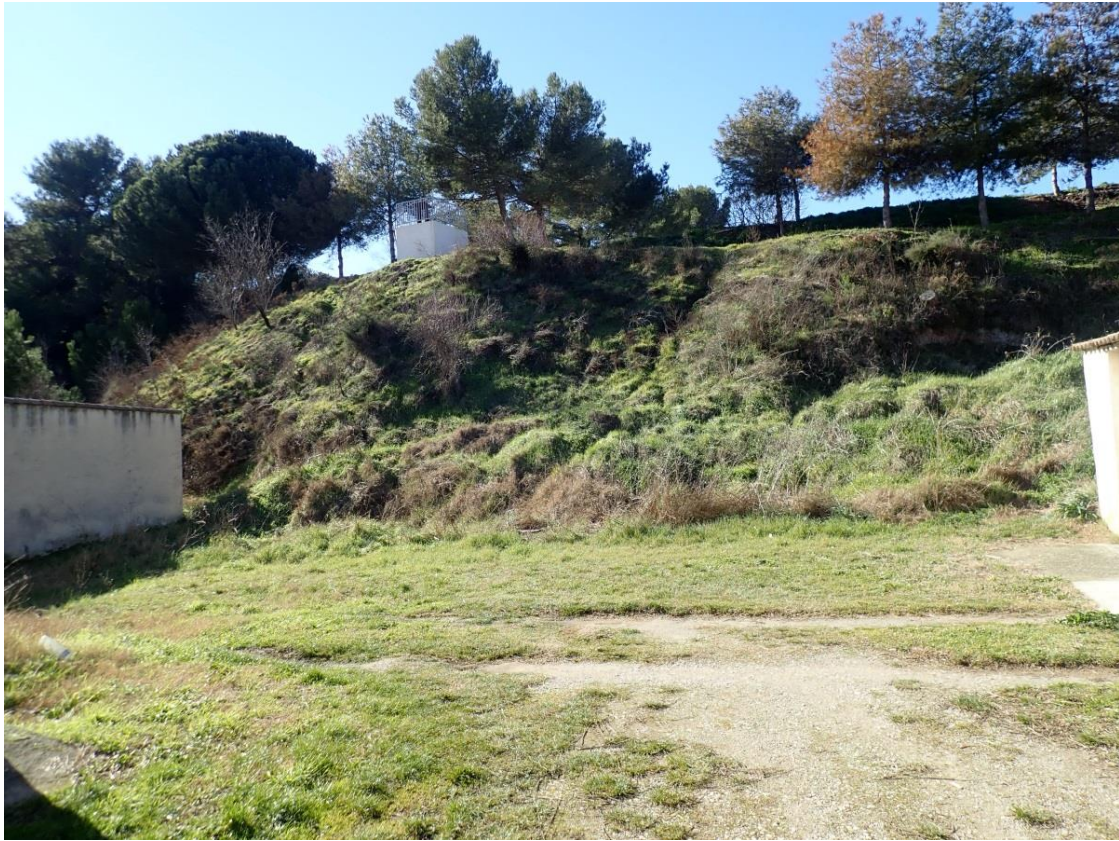
Terril du PHO (V110) – Flanc Est du dépôt principal avec traces de glissements
