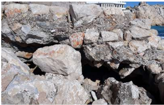
FIGURE 10 : CAVITE PRESENTE SOUS LA DALLE
