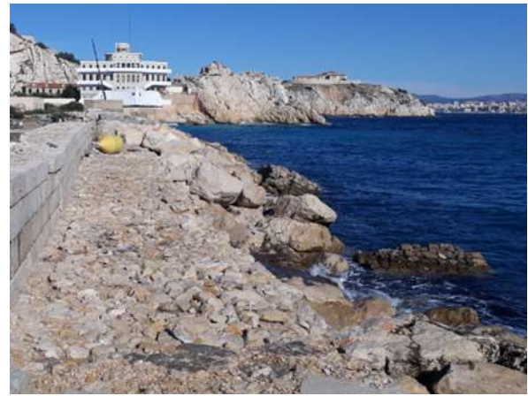
FIGURE 13 : RISBERME MACONNEE DE NOS JOURS FORTEMENT DEGRADEE
