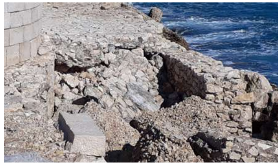
FIGURE 11 : EFFONDREMENT DE LA DALLE SUPERIEURE
