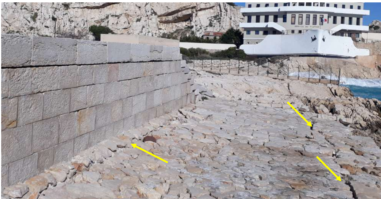
FIGURE 8 : FISSURES CARACTERISTIQUES D'UN TASSEMENT DE LA RISBERME
