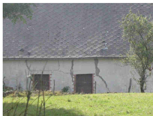
Fissures sur bâtis, charbon, concession des Grousseaux, 63 - © GEODERIS
