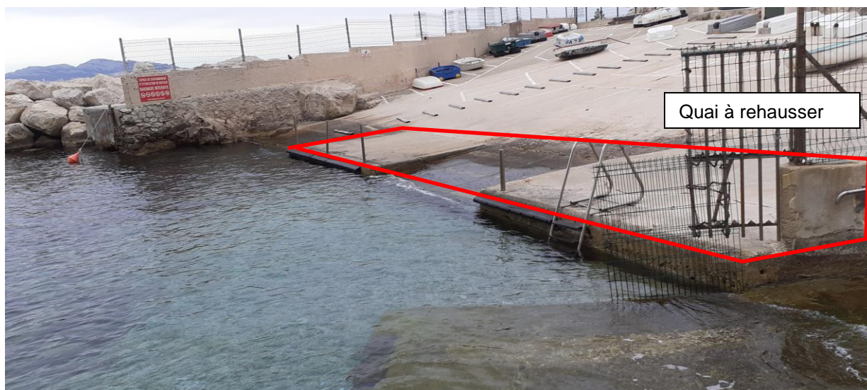
Partie de quai à reprendre
