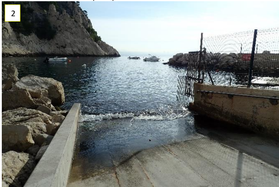
La cale de mise à l'eau à sécuriser
