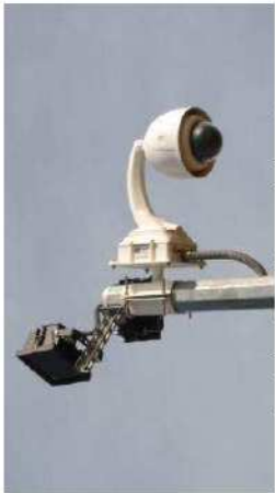
Exemple d'un poteau portant une caméra de surveillance ECOTER, 2013
