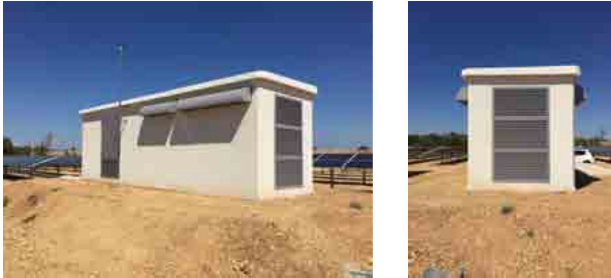
Exemple de poste de transformation
