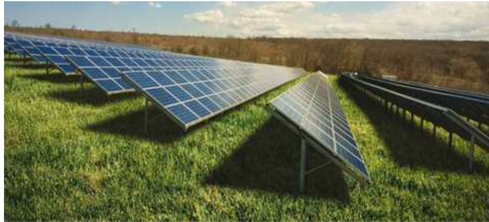
Vue proche des tables photovoltaïques – source URBASOLAR
