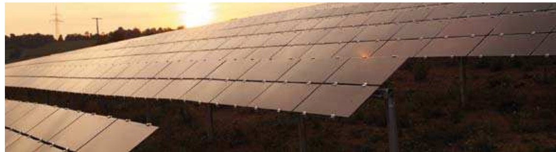
Illustration 7 : tables de modules photovoltaïques (source : First Solar)
