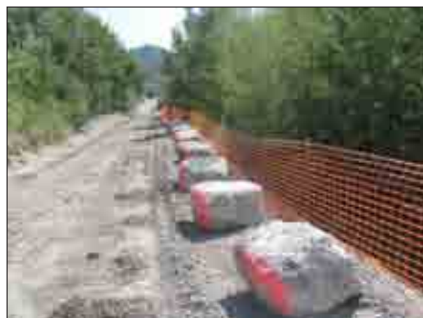
Exemple de mise en place d'un balisage de stations d'espèce protégée et d'un dispositif prévenant contre la sortie accidentel d'engins de la zone d'emprise
