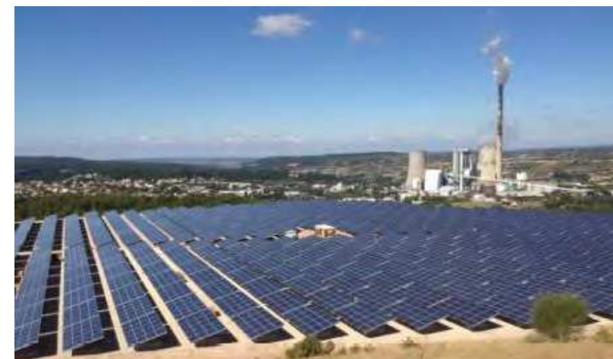
Aménagement d'une centrale photovoltaïque sur un ancien terril à Gardanne (13) (Réalisation Urbasolar)
