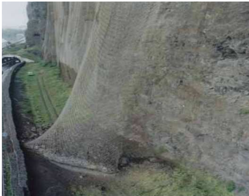
Déviateur – Filet / Grillage pendu
