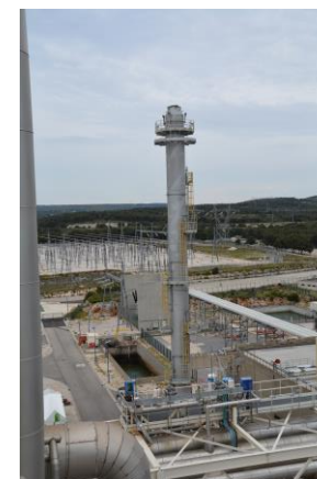
Cheminée de la chaudière auxiliaire du CCG servant de Tour de guet
